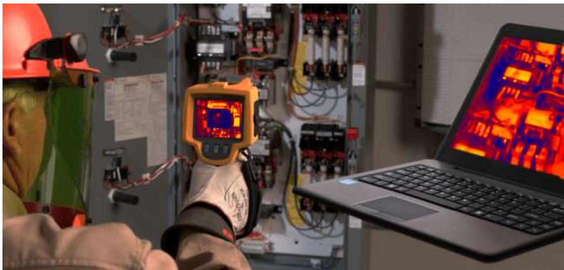
Рисунок 20. Пример проведения тепловизионного контроля электрошкафа
